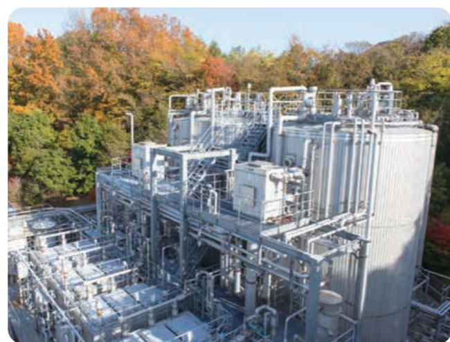
拝田グリーンバイオ事業所にあるメタン発酵設備
