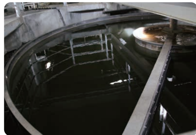
沈殿池にて、基準値内に清澄した排水を下水道へ放流
