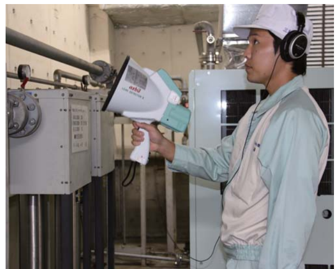
省エネ巡回でエア漏れ診断を行っています
