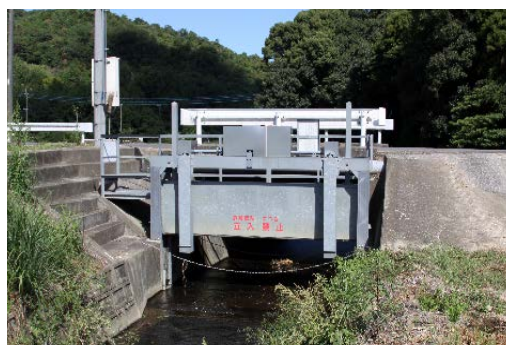
社外水路に設置した緊急遮断弁
